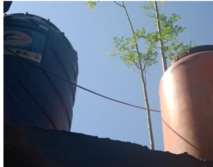
Gambar 2. 10 Bak penampungan air sumur
