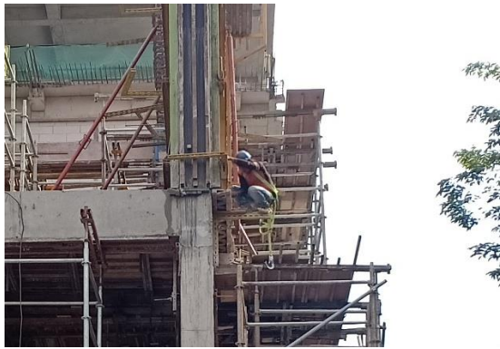
Gambar 14 Pekerja menggunakan full body harness tetapi tidak mengaitkan hook ke lifeline
