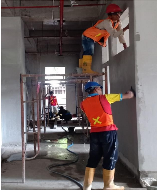
Gambar 13 Pekerja tidak menggunakan full body harness Ketika bekerja di ketinggian
