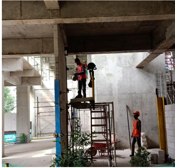
Gambar 11 Pekerja tidak menggunakan APD berupa helm
