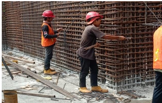
Gambar 12 Pekerja tidak menggunakan APD berupa rompi
