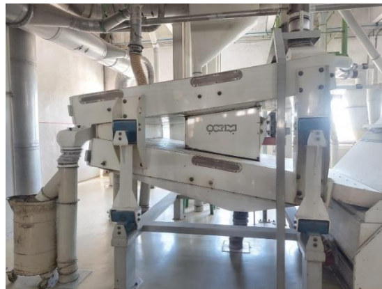
Gambar 1.17. Separator Sumber: Dokumentasi Pribadi (2023)
