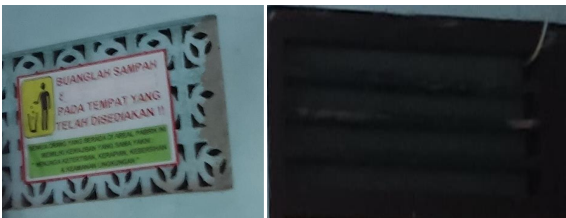
Ventilasi yang terdapat di UKM Putri 21 ( Sumber : Dokumentasi Pribadi, 2021 )
