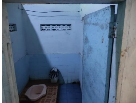
Gambar 2. 2. Toilet di UKM Putri 21 yang tidak terdapat sabun (Sumber: Dokumentasi Pribadi)
