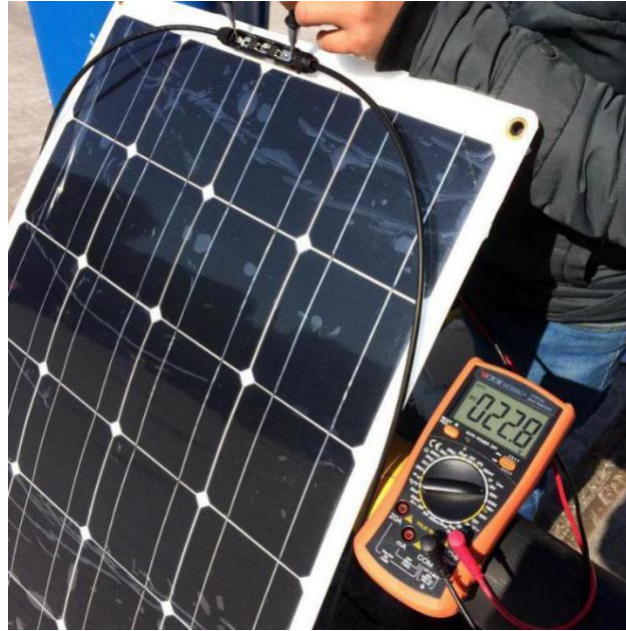
Gambar 14. Perawatan Sistem Panel Surya
