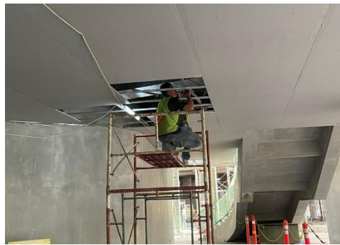
Gambar IV 1 . Pekerja Tidak Menggunakan APD
