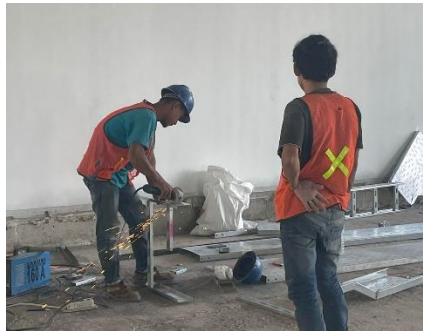
Gambar IV 2 . Tidak Menggunakan Apd Saat Bekerja Menggunakan Alat Mesin
