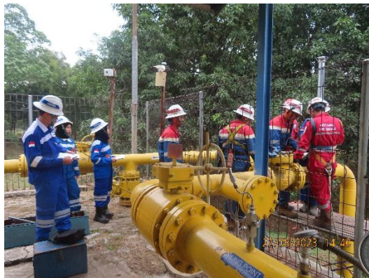
Lampiran 5. Pemeriksaan Laju Korosi Pipa di Area Matering Shelter
