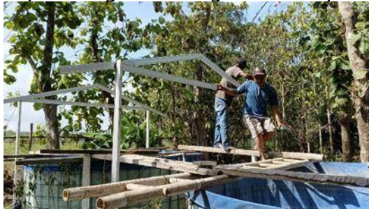
Gambar 4. Perbaikan kembali rangka atap kolam yang diterjang angin ribut
