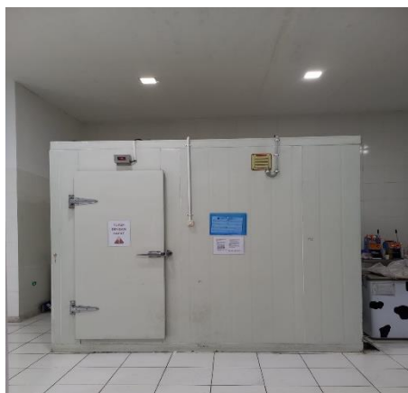
Gambar 1. 31 Cold room Sumber: Dokumentasi Pribadi (2022)
