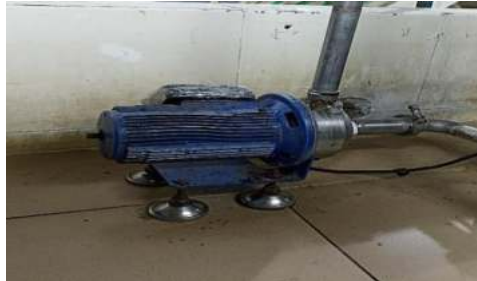
Gambar 1.27 Pompa; Sumber: Dokumentasi Pribadi 2021.
