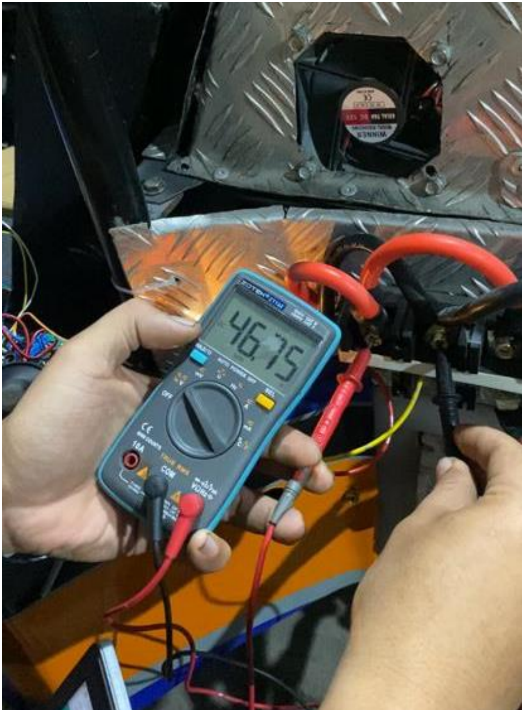
Lampiran 4. Pengecekan tegangan baterai sebagai Ipower supply
