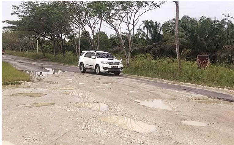
Gambar 1.1 Kondisi Jalan Rusak akibat ODOL
