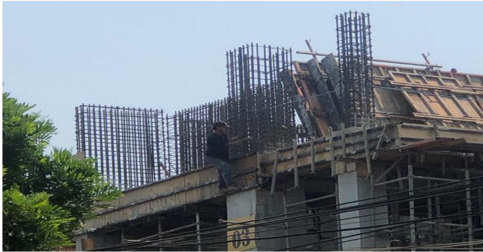
Gambar 1.3 Pekerja tidak menggunakan helm dan sabuk pengaman
