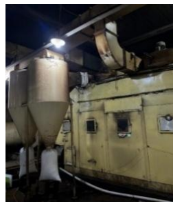
Gambar 1. 27 Mesin Fluid Bed Dryer Sumber: Dokumentasi Pribadi
