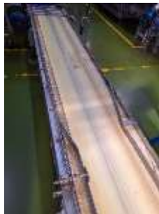
Gambar 1.25. Belt Conveyor. (Sumber: Dokumentasi Pribadi, 2024)
